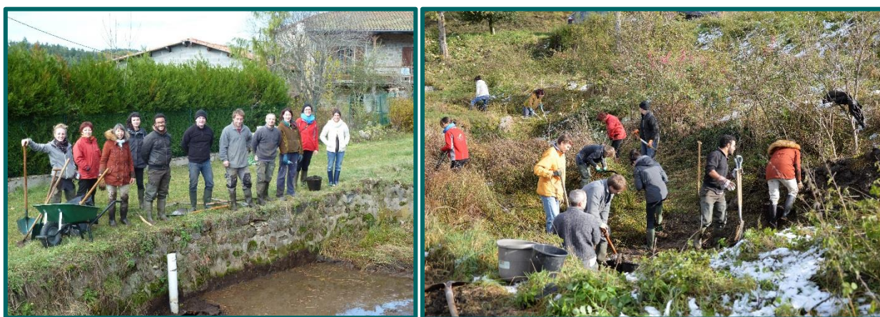
Photos 32 et 33 : Equipe de bénévoles, d'habitants et d'élus réunis autour du chantier de restauration de Saint-Didier-sur-Rochefort
