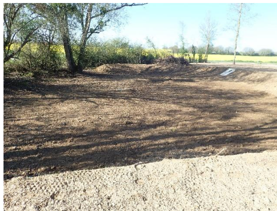
Travaux réalisés en 2022 à l'endroit où se trouvait la mare de Vouneuil-sous-Biard en 2009
