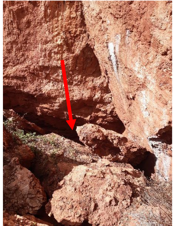
EFFONDREMENT NORD AVEC CAVITÉ
