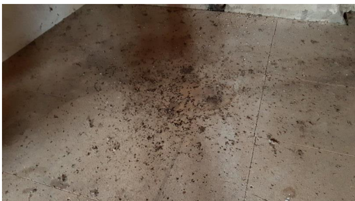
Figure 43 : Ancien guano éparpillé dans le grenier de la cantine
