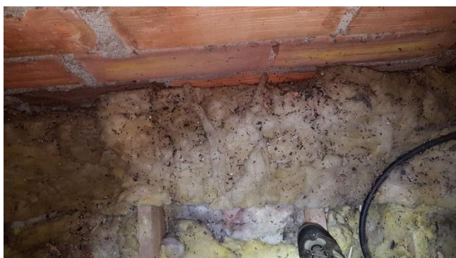
Figure 45 : Ancien guano de chiroptères sur la laine de verre du grenier de l'école
