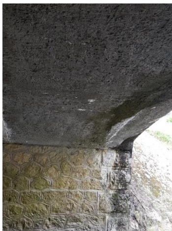
Figure 47 : Pont situé au lieu-dit Neuillé dont la voute a été totalement cimentée ne proposant pas d'anfractuosités pour les chiroptères
