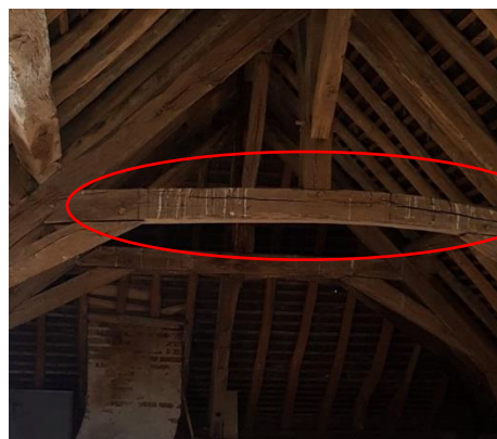
Figure 44 : Anciennes traces de fientes de chouettes sur les poutres du grenier de la cantine
