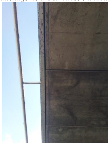
Exemple de micro-gîte dans une corniche du pont de la Vendée
