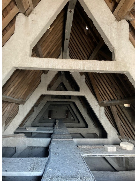
Figure 33 : Exemple de comble favorable à la présence de rapaces nocturnes ou de chauves-souris
